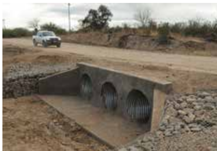
Imagen N° 15 - Alcantarilla transversal de sección múltiple
