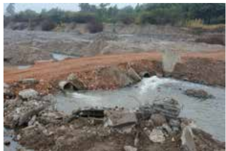
Imagen N° 17 - Alcantarilla con alto proceso de erosión
