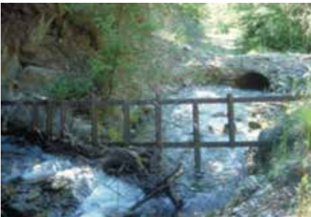
Imagen N° 19 - Rejas de protección en entrada de alcantarilla
