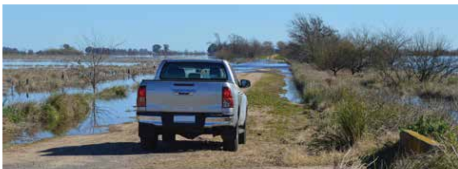
Imagen N° 3 - Falta de un perfil adecuado
