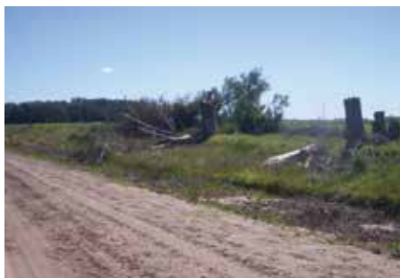
Imagen N° 6 - Desagüe longitudinal obstruido por ramas y malezas
