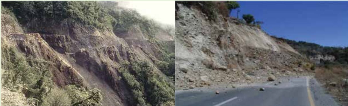
Taludes inestables conducen a erosión y deslizamientos
