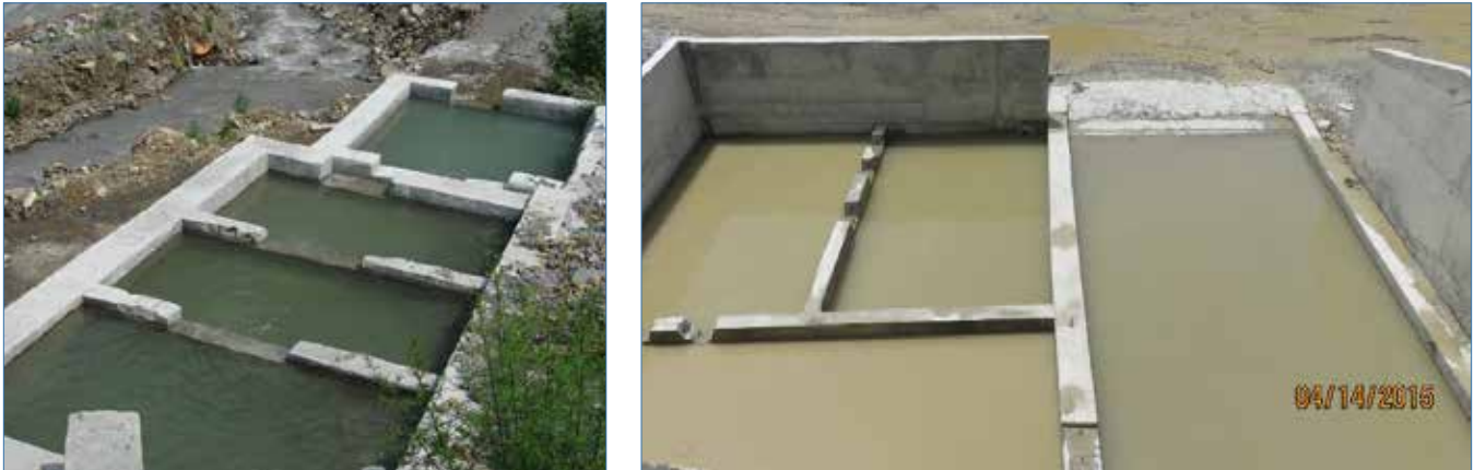
Figura 12. Tanque de sedimentación de pasos múltiples
