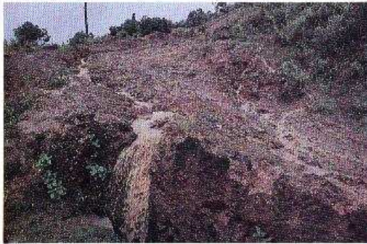
Foto 11-3. Si no se toma acción para controlar la erosión, el resultado será daño severo al camino y la degradación de la calidad del agua. Huehuetenango, Guatemala. (Foto G. Keller)
