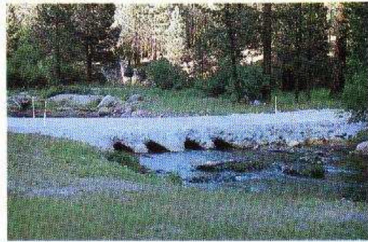
Foto 7-4. Un ejemplo de un badén mejorado de concreto sobre tubería para flujo de bajo volumen, con gramíneas sembradas en las orillas para proteger el suelo. Bosque Nacional Plumas, California, EE.UU.
