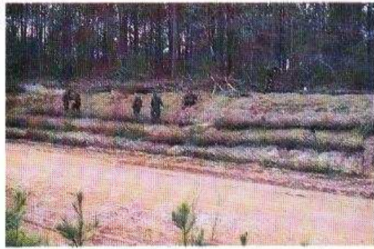
Foto 11-13. Un ejemplo de la técnica revegetativa de la aplicación de capas de ramas en un corte de talud. Georgia, EE.UU. (Foto de R.B. Sotir & Associates)
