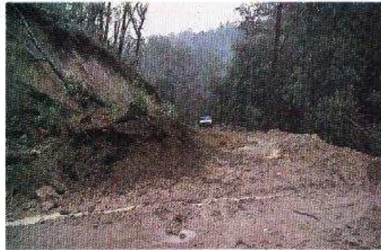
Foto 10-1. Un diseño inadecuado y un corte del talud muy empinado puede causar deslizamientos o daños mayores al camino y mayores problemas ambientales. Chimaltenango, Guatemala. (Foto G. Bauer)
