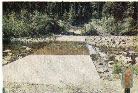
Foto 7-5. Un badén mejorado de concreto con buena protección aguas abajo y un muro de guardia para evitar la socavación. Bosque Nacional Plumas, California, EE.UU. (Foto G. Keller)
