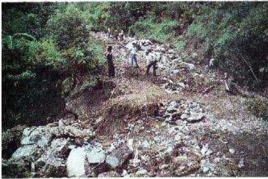
Foto 9-1. Un camino mal diseñado y construido con drenajes inadecuados fracasará. En estos casos el costo de mantenimiento y el impacto ambiental será muy elevado. El Progreso, Guatemala. (Foto G. Bauer)
