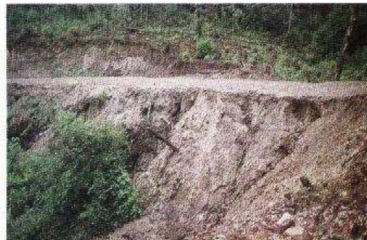
Foto 10-4. Un ejemplo de una falla total de un talud de relleno causado por una inclinación excesiva y la falta de compactación adecuada del relleno. Chimaltenango, Guatemala. (Foto G. Bauer)
