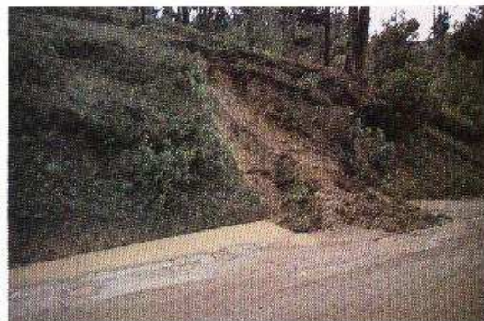
Foto 10-6. Un corte sobreinclinado retiene el agua en el talud y puede causar un deslizamiento o deslave. En este caso el corte debe ser más plano. Totonicapán, Guatemala. (Foto G. Bauer)
