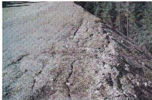
Foto 10-3. El asentamiento de material de relleno flojo sin compactación puede causar erosión a lo largo del camino. Chimaltenango, Guatemala. (Foto G. Keller)
