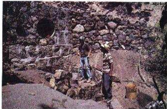
Foto 9-10. La altura de la salida de la alcantarilla es demasiado alta y como consecuencia, puede erosionar el fondo del canal. Por tal motivo, están construyendo un dissipador de energía. Sololá, Guatemala. (Foto GB)
