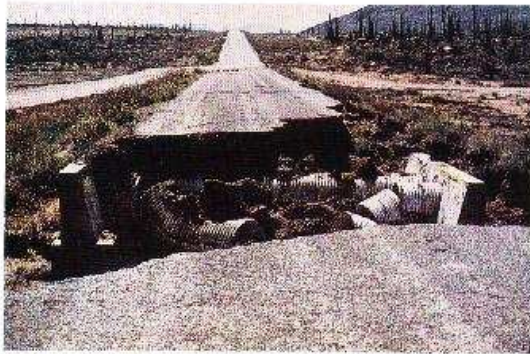
Foto 9-7. Una alcantarilla de un tamaño inadecuado mal instalada resultará en fracaso total y el deslave del camino. Baja California, EE.UU. (Foto Club Vagabundos)
