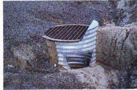
Foto 9-4. Una estructura de boca de caída mejorada de tubo de metal corrugado con una percha de desechos. Bosque Nacional Plumas, California, EE.UU. (Foto G. Keller)
