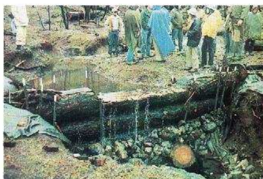
Foto 12-12. Un ejemplo de un dique de contención de trozos de madera y piedra bien construido y anclado en una orilla estable. Bosque Nacional Plumas, California, EE.UU. (Foto G. Keller)
