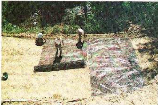
Foto 10-11. Un ejemplo de un relleno reforzado con georejilla. Bosque Nacional Plumas, California, EE.UU. (Foto G. Keller)
