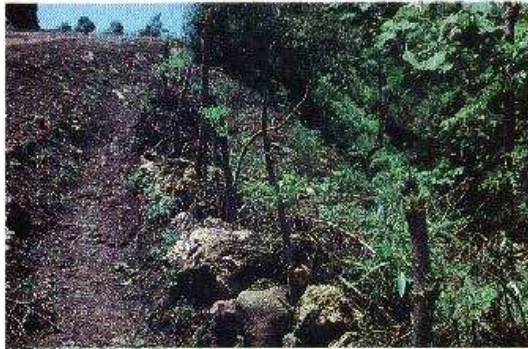
Foto 11-7. Una técnica para controlar la erosión es el uso de estacas vivas. Nótase el rebrote en la estaca y el plantón de ciprés. Las estacas fueron sembradas hace un mes. Huchuetenango, Guatemala. (Foto G. Keller)
