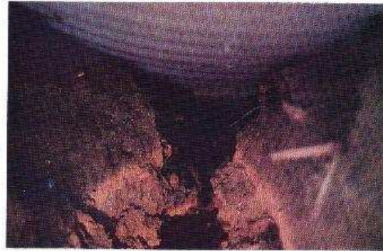
Foto 9-8. Un ejemplo de socavación debajo de una alcantarilla causada por un diseño inapropiado y compactación inadecuada del material. Bosque Nacional Plumas, California, EE.UU. (Foto G. Keller)
