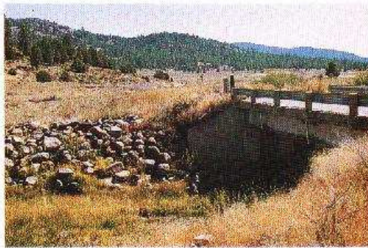
Foto 6-4. Un ejemplo de zampeado y vegetación utilizados para proteger las orillas río arriba y abajo de un puente de tramo corto de concreto. Bosque Nacional Plumas, California, EE.UU. (Foto G. Keller)
