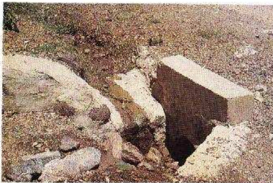
Foto 9-9. Una boca de caída con un muro cabecera de concreto para reducir al mínimo la acción de socavación. Huehuetenango, Guatemala. (Foto G. Keller)
