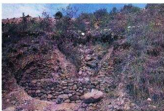
Foto 12-11. Vista desde el frente de un muro de gaviones bajo construcción en una pendiente fuerte. Cochabamba, Bolivia. (Foto G. Bauer)
