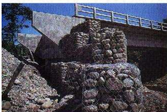
Foto 6-3. Un puente de concreto, bajo construcción con gaviones y aleros bien diseñados, para proteger las orillas del riachuelo. Chapare, Bolivia. (Foto G. Bauer)
