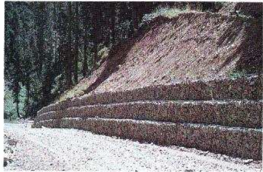
Foto 10-8. Un ejemplo de gaviones convencionales típicamente utilizados para estabilización de taludes. Bosque Nacional Plumas, California, EE.UU. (Foto G. Keller)
