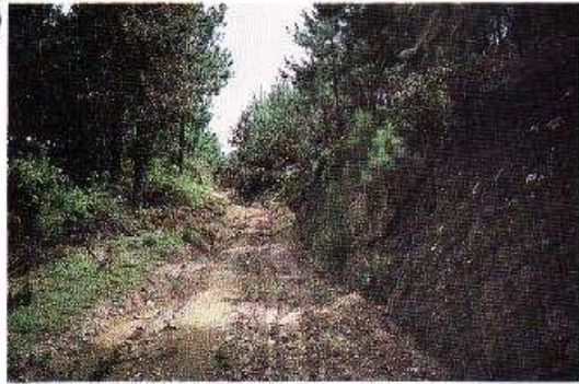
Foto 13-1. Un camino rural severamente dañado con rodaduras como resultado del uso de subrasante blando y drenajes inadecuados. Nótese el corte de talud inestable y sobreinclinado. Huehuetenango, Guatemala. (G. Bauer)
