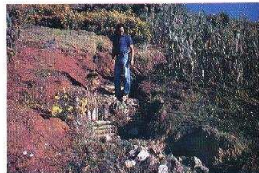
Foto 12-6. El mismo lugar un año después de haber hecho la restauración. Nótese como el dique se ha llenado de arrastre y vegetación natural ha crecido. Huehuetenango, Guatemala. (Foto G. Bauer)
