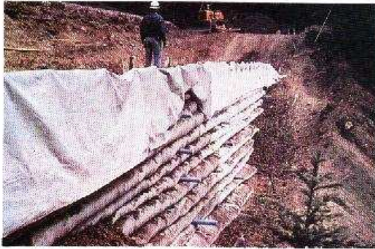
Foto 10-9. Un ejemplo de un muro de contención de tierra reforzado con geotextil. Bosque Nacional Plumas, California, EE.UU. (Foto G. Keller)
