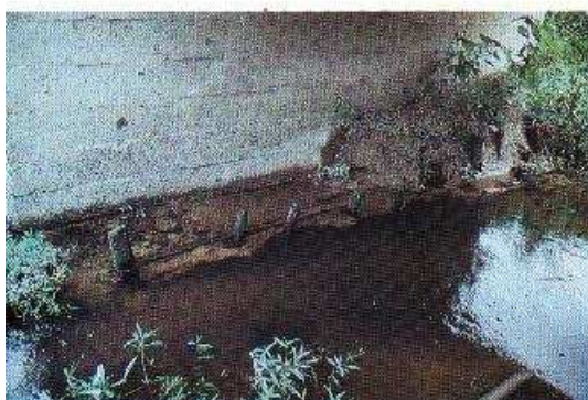
Foto 6-5. Un ejemplo de un estribo de un puente de concreto con cimientos inadecuados. Nótese el hoyo de socavación que está formando. Chapare, Bolivia. (Foto G. Keller)
